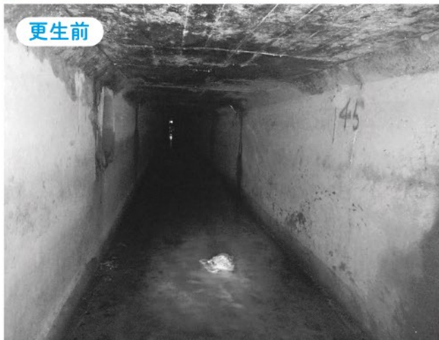
管渠の上部が腐食しています。
