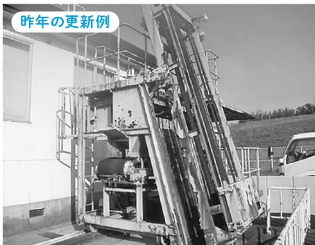
更新前の除塵機（和久市第1ポンプ場）
