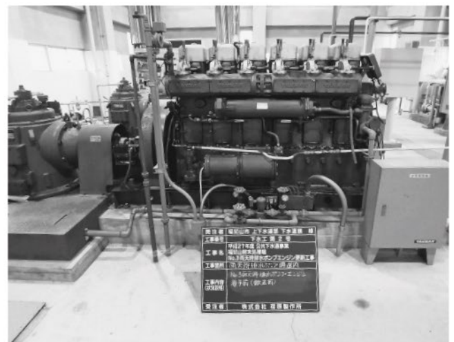
更新前の排水ポンプ駆動用エンジン。（終末処理場内）
